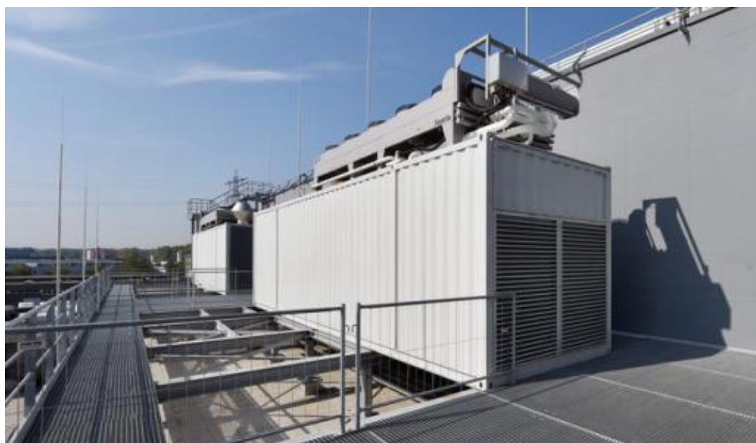
Die Notstromaggregate auf dem Dach des "IPC IV" der Karlsruher Telemaxx GmbH. Foto: Telemaxx
